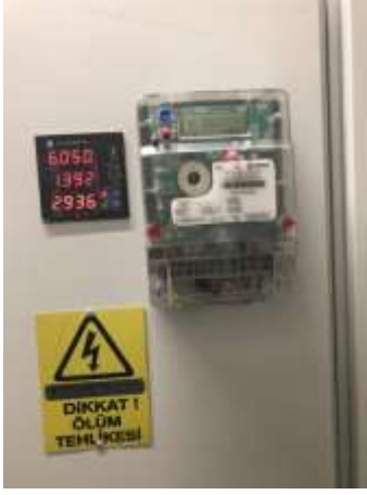
Bina Elektrik sayacı
